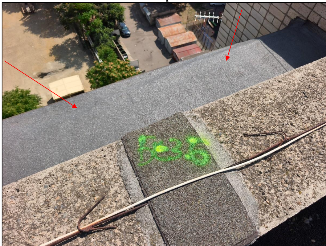
Отсутствие парапета (ограждения) кровли в осях 20-23/Ж
